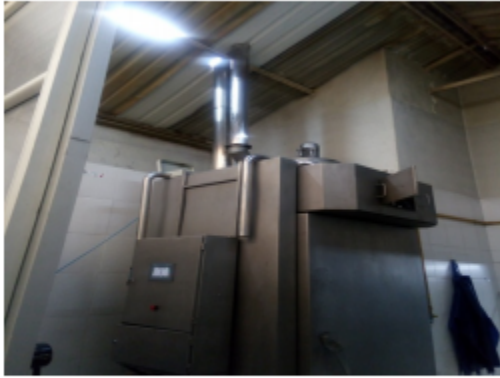
Fotografía No. 3 Ducto de desfogue del horno de ahumado
